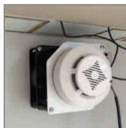
Unité de ventilation intégrée avec détecteur de fumée
